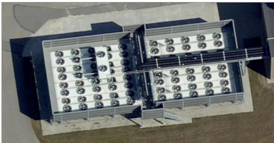
Figur 9-4: Luftfoto af de 2 ventilator-aggregater, som forsyner Ringkøbing Fjernvarmes 3,3 MWq luftvarmepumpe. Hvert aggregat indeholder 40 ventilatorer og måler netto 12 x 12 m. Bemærk, at de angivne lyddæmpende foranstaltninger, som Ringkøbing Fjernvarme har udført rundt om aggregaterne ikke er estimeret.
